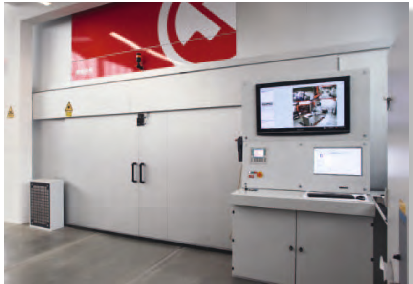
Die Steuer- und Bedieninstrumente der Anlage sind im zentralen Steuerpult übersichtlich zusammengefasst.
